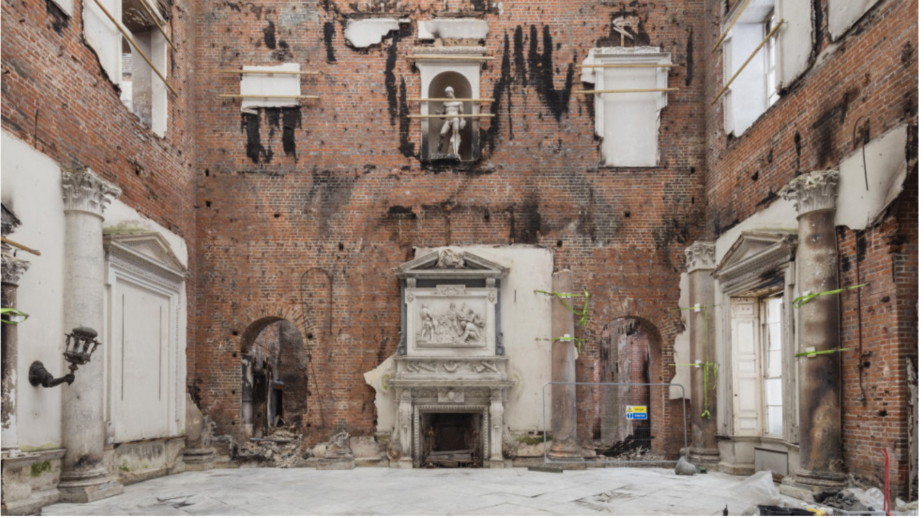
Resim: 26 Yangın sonrası Clandon Park'ın durumu, 2015 (Foto: https://www.artfund.org/what-to-see/museums-and-galleries/clandon-park-house )
