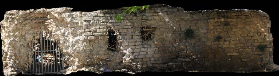
Resim: 10 Kale Hamamı lazer tarama sonucundan elde edilen orto foto güney cephesi giriş bölümü (Y-Kare Mimarlık, 2016).
