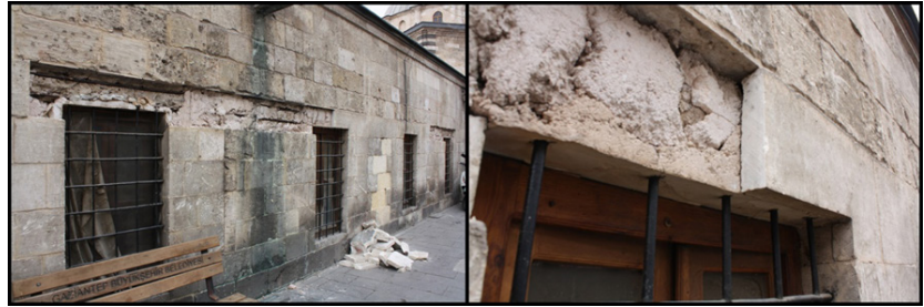
Şekil 26. Pencere üstlerinde yer alan hatıllar, korozyona uğramış donatılar ve deprem sonrası düşen cephe taşları (Cansunar arşivi, 2023)
