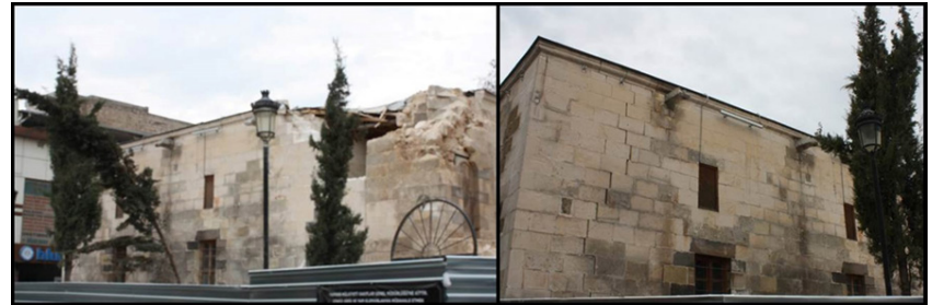
Şekil 7. Deprem sonrası yapıda oluşan tahribatlar (Cansunar arşivi, 2023)
