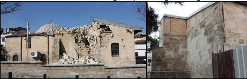
Şekil 4. Deprem sonrası yapıda oluşan tahribatlar (Cansunar arşivi, 2023)
